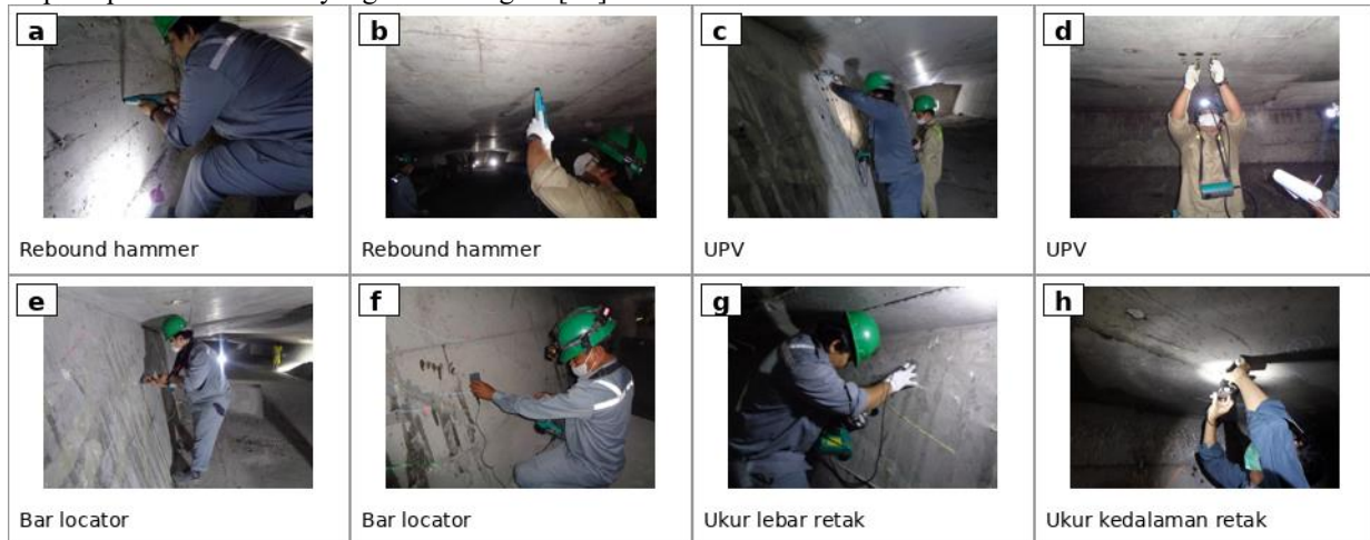
Gambar 7. Dokumentasi pengujian non-destruktif (NDT) di lapangan: (a)–(b) rebound hammer; (c)–(d) Ultrasonic Pulse Velocity (UPV); (e)–(f) bar locator; dan (g)–(h) pengukuran lebar dan kedalaman retak.
