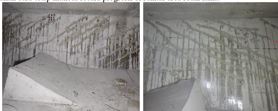
Gambar 2. Kondisi Kerusakan Dinding Box Girder
